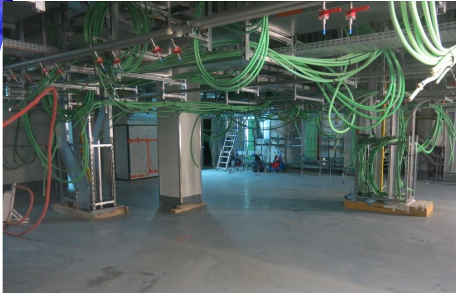
Salle des Alimentations et électronique (début installation des baies cette semaine)
